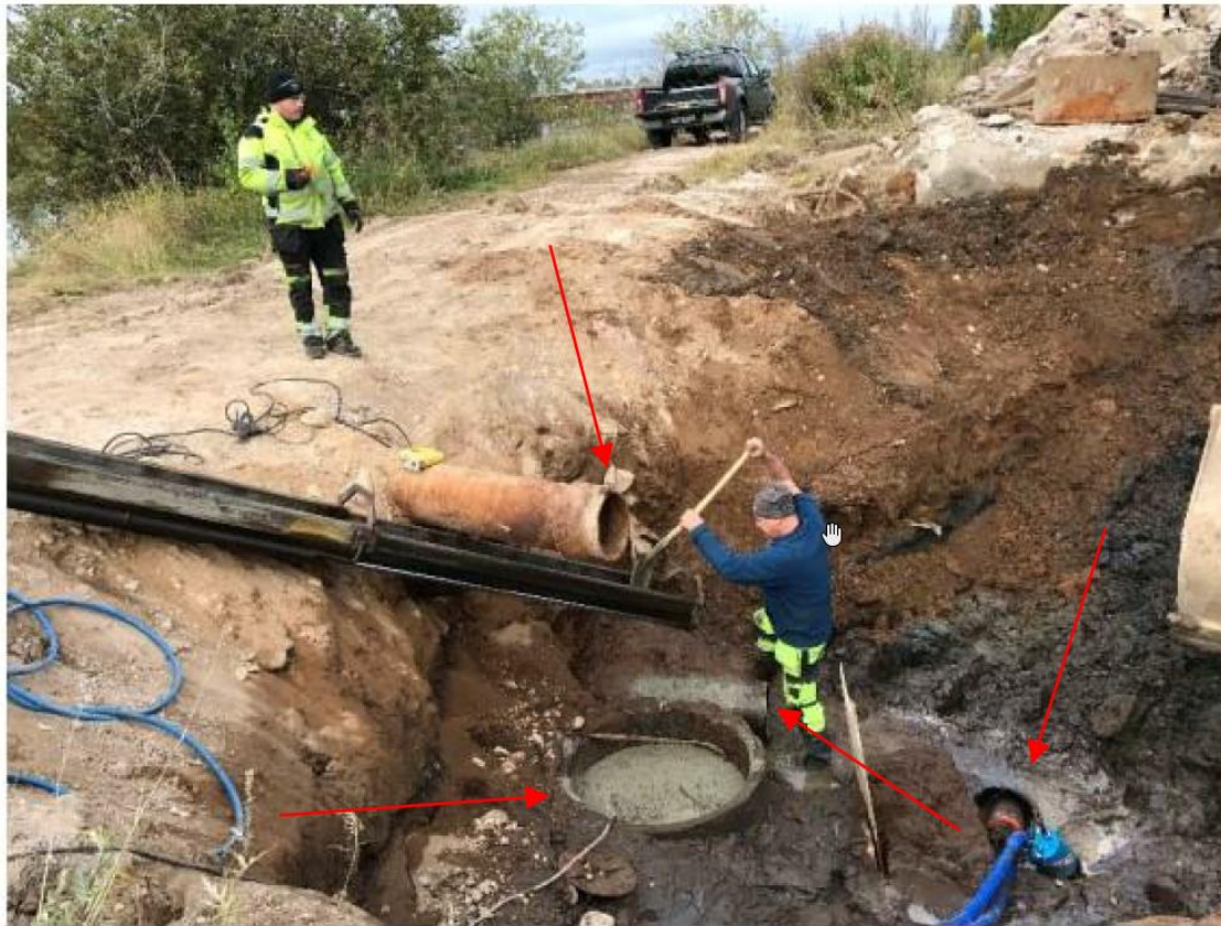
Figur 21. Foto från genomförd akutsanering (Geosigma, 2018a), då påträffade rör pluggas igen. Röda pilar indikerar påträffade rör. Det översta röret skulle kunna vara en dagvattenledning och den breda cementringen den västligaste nedstigningsbrunnen. De två djupare rören skulle kunna tillhöra avloppssystemet. Röret nere till höger ger en indikation om djup till ledningssystemet. Foto: Geosigma.
